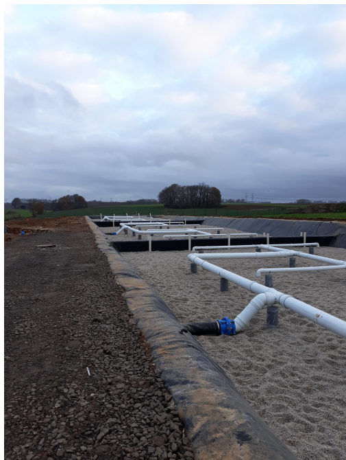
Le 2ème étage du filtre à sable
