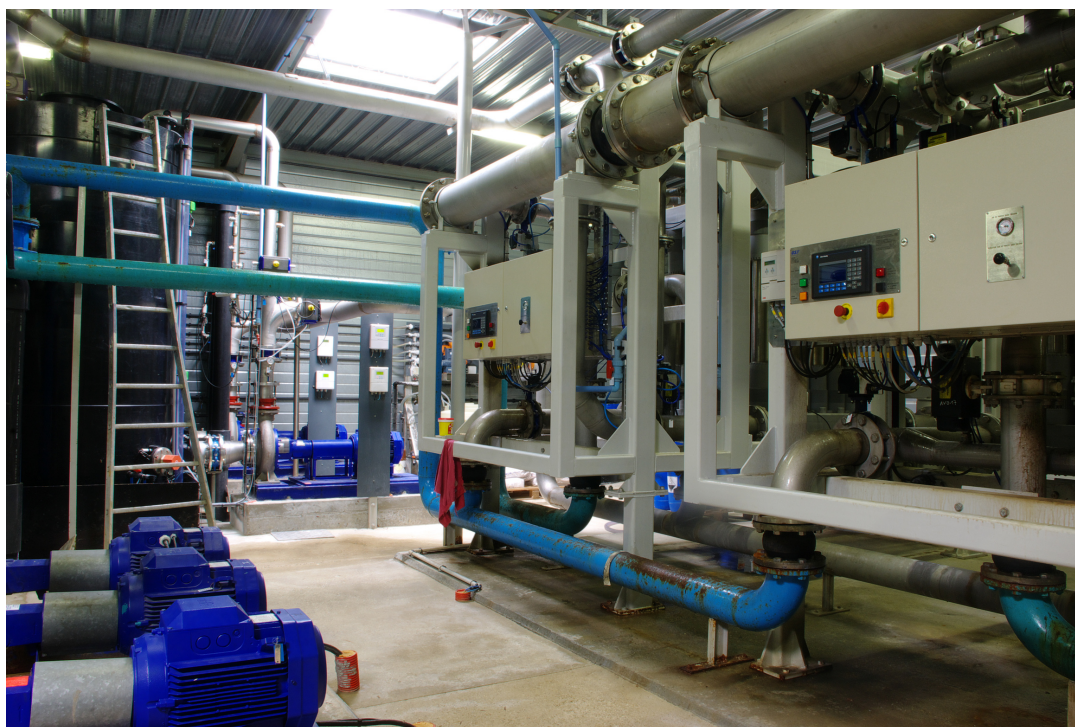
Actuelle usine d'eau potable
